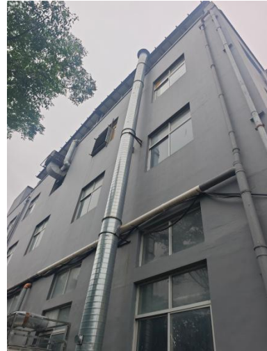
注塑废气处理设施排气筒
