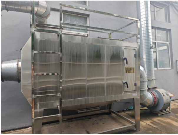
注塑废气处理设施
